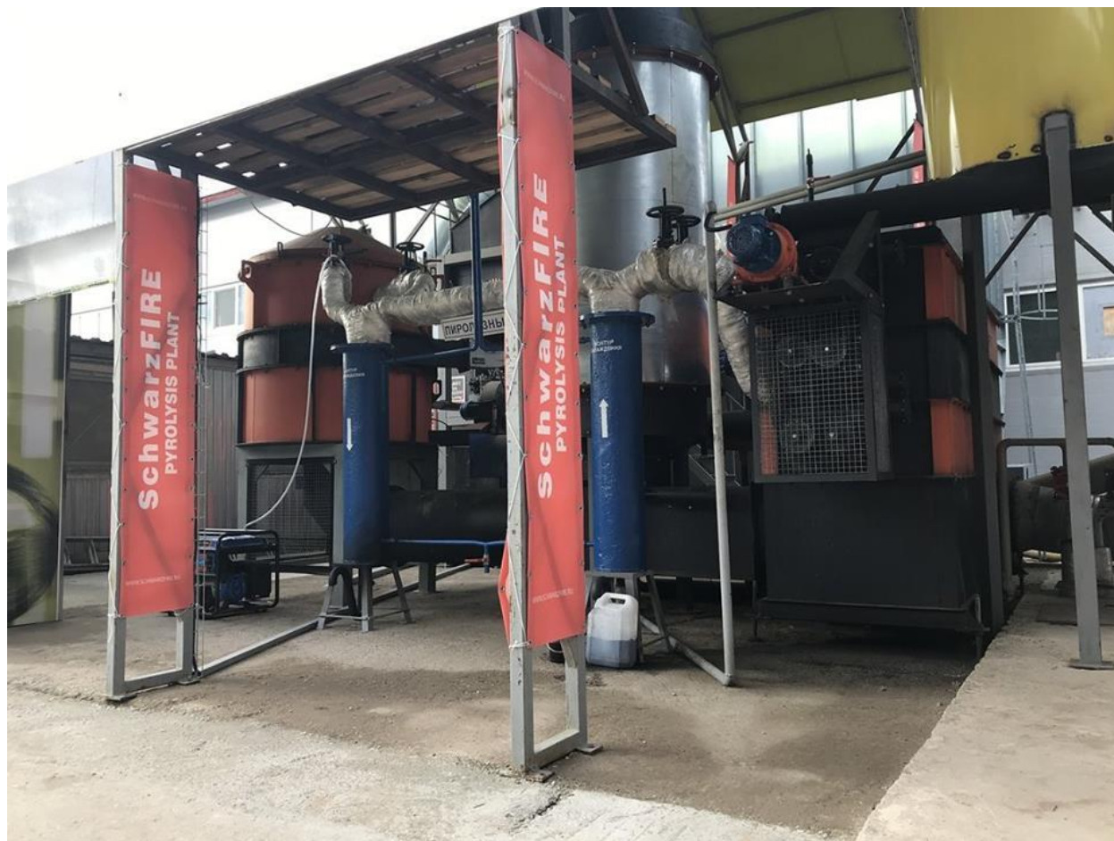
Рис.3. Котельная на всех видах отходов в Щапово. (Слева – горелка, в центре оцинкованный – котел, вправо от котла – реторта непрерывного действия, желтый – бункер с отходами, синие – конденсаторы выделения пиролизной жидкости и очистки газа, слева внизу перед горелкой – газопоршневой электрогенератор).
